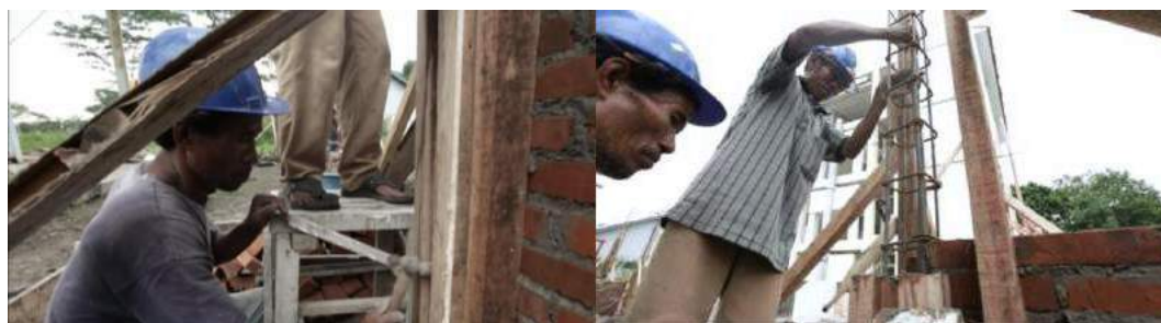
Gambar II.416 Pemadatan Beton Dengan Memukul-mukul Cetakan/ Bekisting dan Campuran Beton Dirojok Menggunakan Besi atau Bambu
